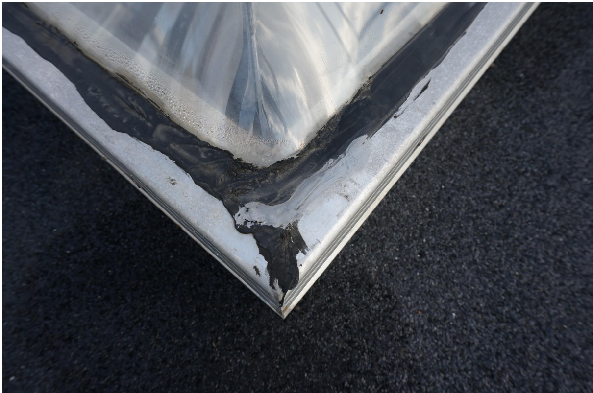
Billede viser tætning af vindue mellem akryl og aluramme, dette sammen med en vandnæse absolut mindste krav og bør udføres med det samme på alle huse, hvor der ikke er lavet udbedringer
