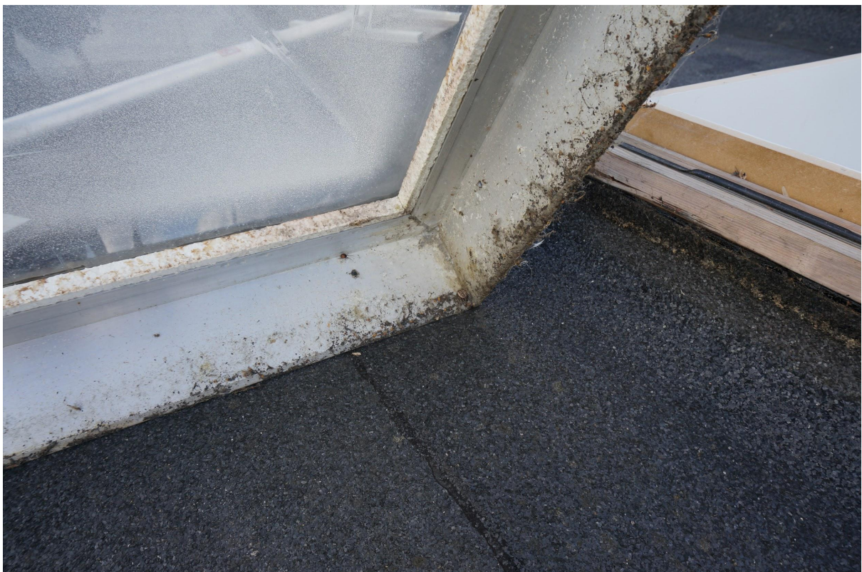
Billede viser indvendig aluramme, som monteres på trærammen, dette er en af de primære årsager til vand indtrængen via vind - vand skubbes ind.
